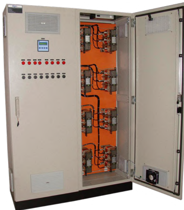
Figura 7. Banco de capacitores sintonizados
