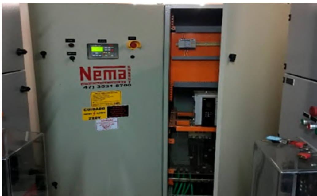
Figura 7 Quadro de transferência automática.
