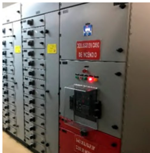
Figura 5 Quadro de distribuição geral de baixa tensão.
