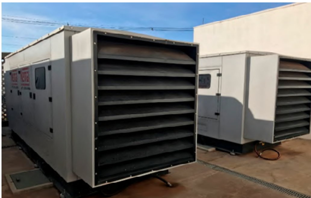
Figura 6 Grupo gerador do CCE.
