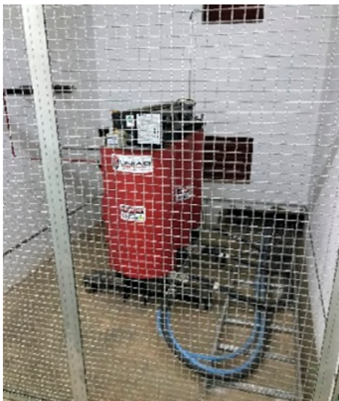
Figura 4 Transformador abaixador de tensão 13,8kV para 220V.
