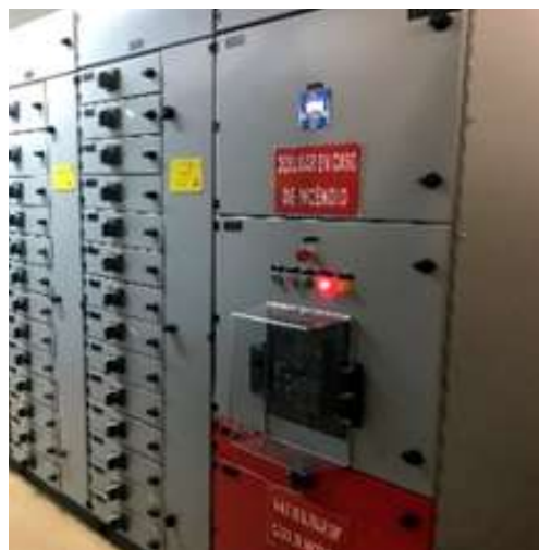
Figura 5 Quadro de distribuição geral de baixa tensão.
