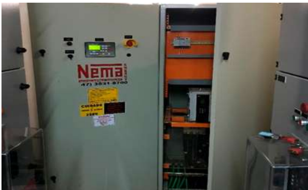
Figura 7 Quadro de transferência automática.
