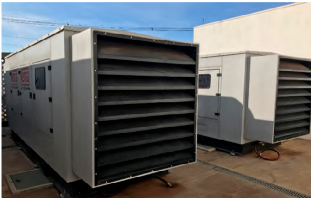
Figura 6 Grupo gerador do CCE.
