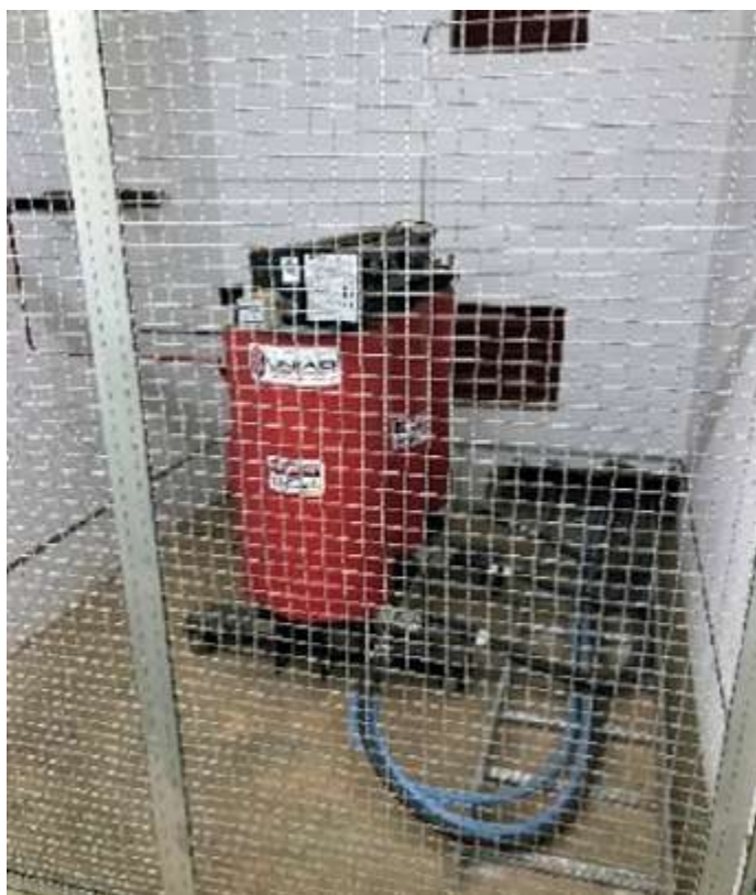
Figura 4 Transformador abaixador de tensão 13,8kV para 220V.
